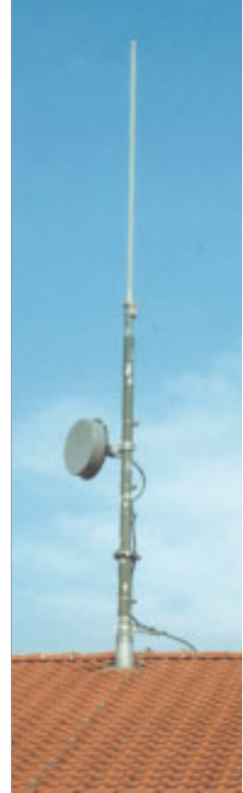
Mobilfunk- Rundstrahlantenne (Stab) und Richtantenne (rund).
